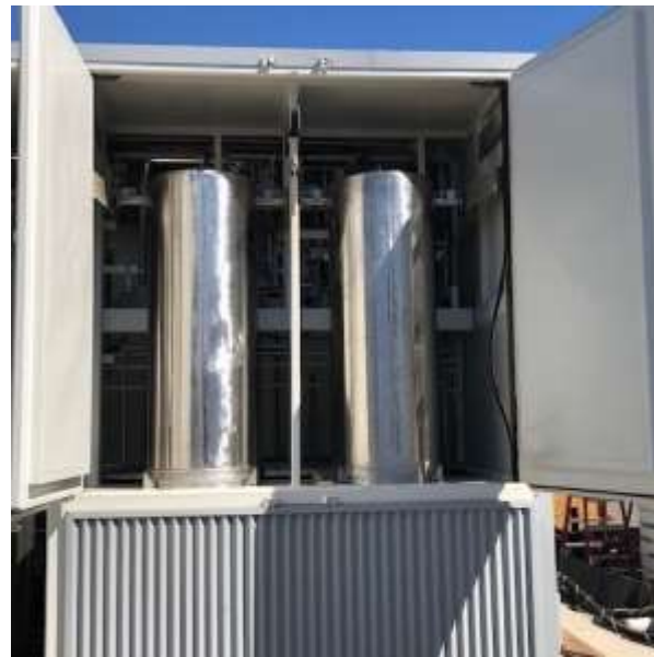
Fig. 4b. TSCR Filter Modules
