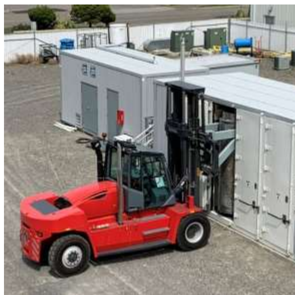
Fig. 3b. TSCR IXC Installation
